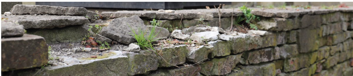
Foto. 7. Rozwarstwienie cementowej wyprawy górnej płaszczyzny wschodniego murku kwatery 24.
