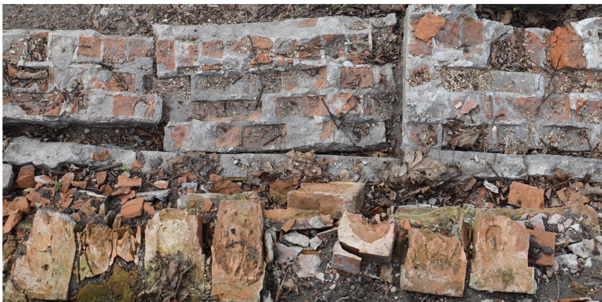
Foto. 8. Kwatera 31, ściana zachodnia. Tynk cementowy odspojony od muru oporowego. Wtórnie położone tynki cementowe, przez swoją silną adhezję do ceramiki i małą porowatość w połączeniu z migrującą wilgocią i transportowanymi w niej związkami chemicznymi a także warunkami silnie zażewionej ekspozycji zewnętrznej doprowadziły do osłabienia i rozwarstwienia cegieł co w wielu odcinkach doprowadziło do odspojenia wypraw wraz z fragmentami murów.
