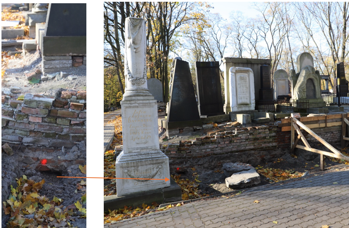
Foto. 4. Kwatera 19, mur oporowy od strony wschodniej z zaznaczonym bardzo płytkim posadowieniem.
