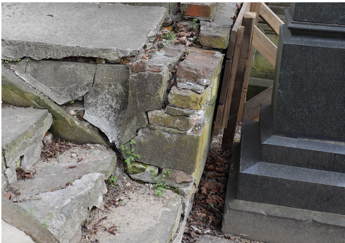
Foto. 9 Kwatera 31, ściana południowa, pionowe rozwarstwienie muru, uszczelnionego mało porowatą zaprawą cementową
