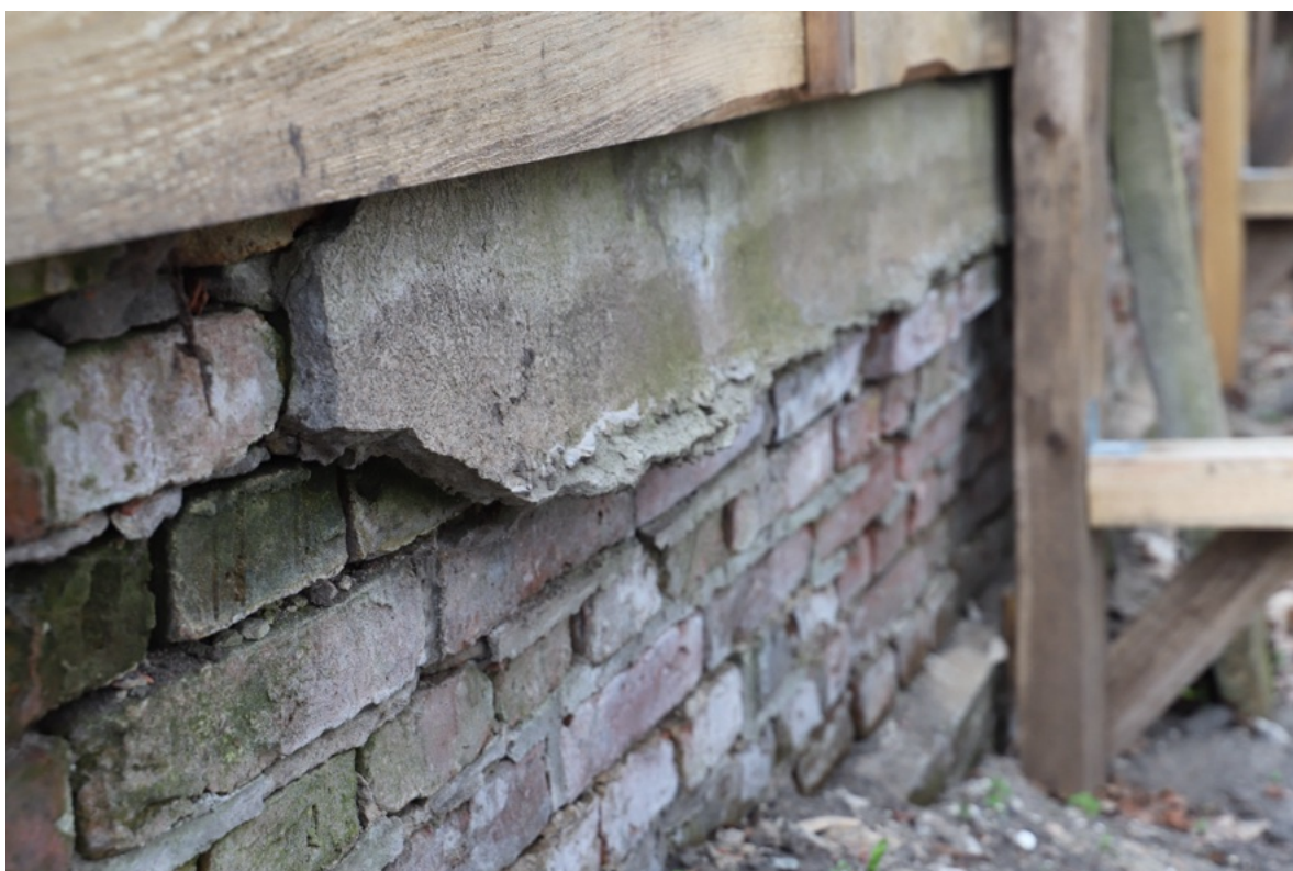
Foto. 11-13. Kwatera 19, Rozspojenia cementowych spoinowań i rozwarstwienie cementowej wyprawy tynkarskiej.
