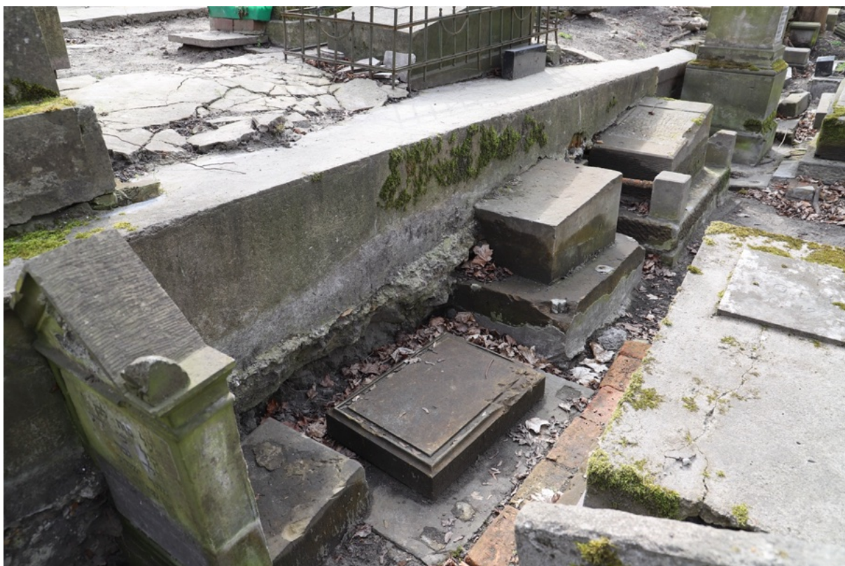
Foto. 189-190. Kwatera 31. Widok ogólny ściany północnej z zachowaną cementową wyprawą tynkarską nieregularnie zaciągniętą na górne płaszczyzny nagrobków.
