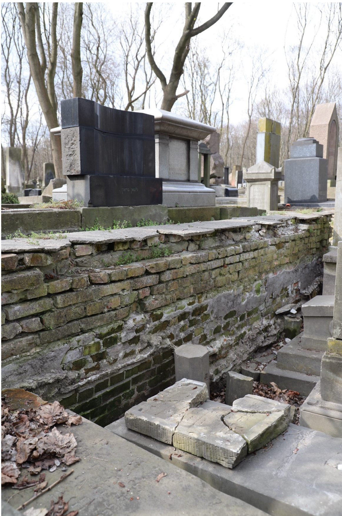
Foto. 55. Kwatera 24. Front muru wschodniego. Widoczny zróżnicowany stan zachowania muru z wytukaną zaprawą spoinową, obudowywanie części składowych nagrobków oraz szczątkowo zachowane cementowe tynki, których spodnie krawędzie sięgają różnych wysokości.
