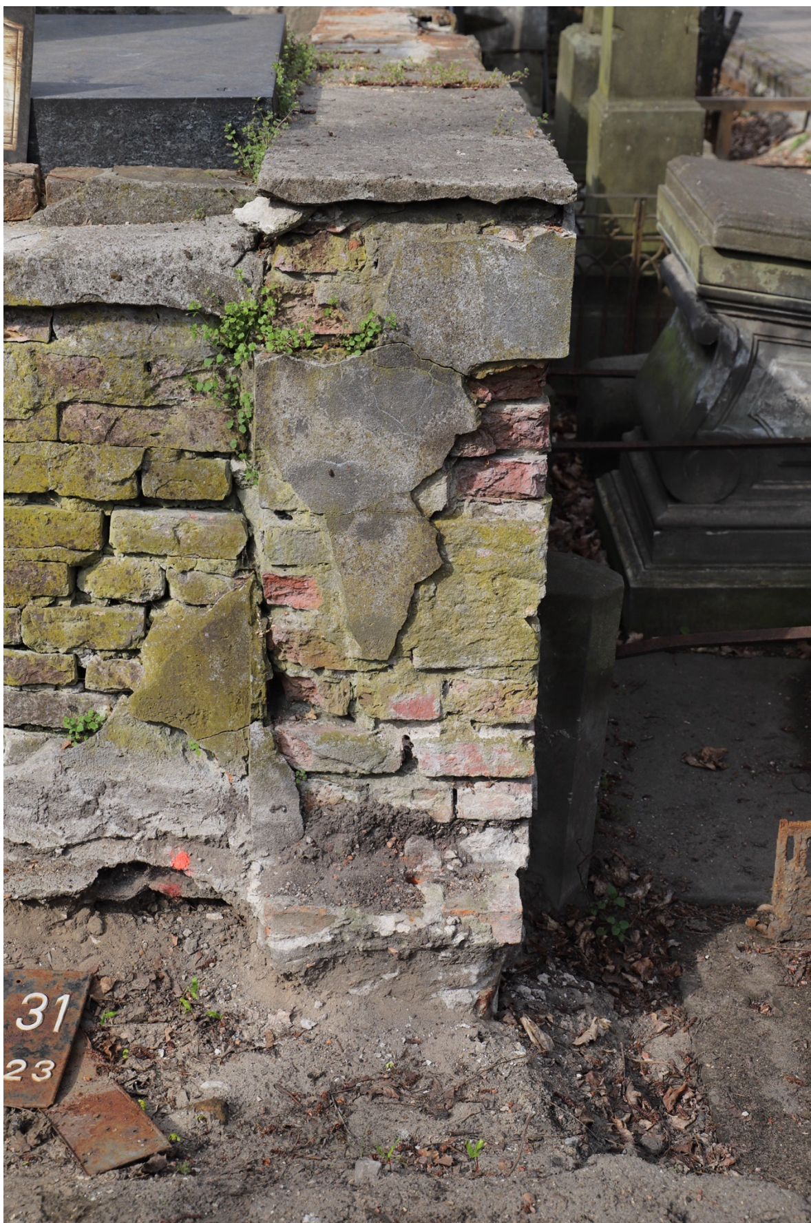
Foto. 125. Kwatera 31. Widok narożnika południowo-wschodniego z zaznaczoną różową farbą spodnią, najniższą częścią muru. Widoczne rozwarstwienia, wykruszenia spoin oraz odspojony, szczątkowo zachowany tynk cementowy.
