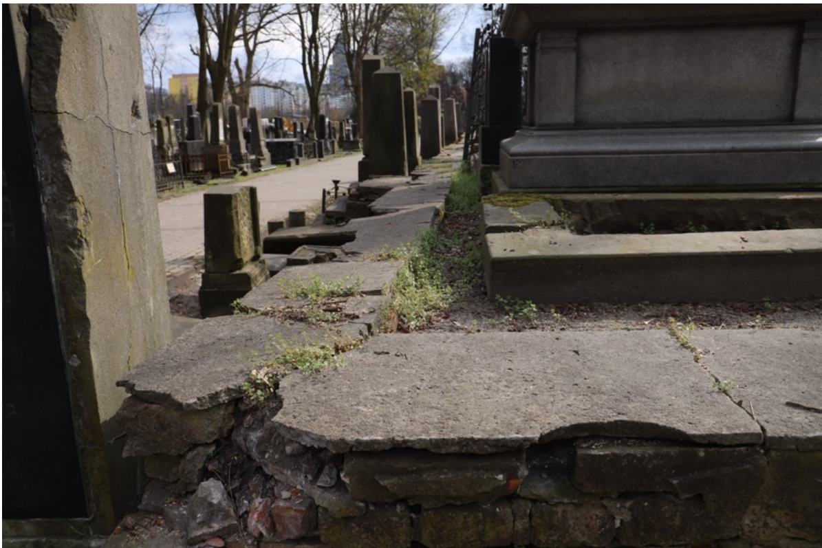
Foto. 40-42. Kwatera 24. Cementowe zwieńczenie muru wschodniego z widocznymi rozwarstwieniami.
