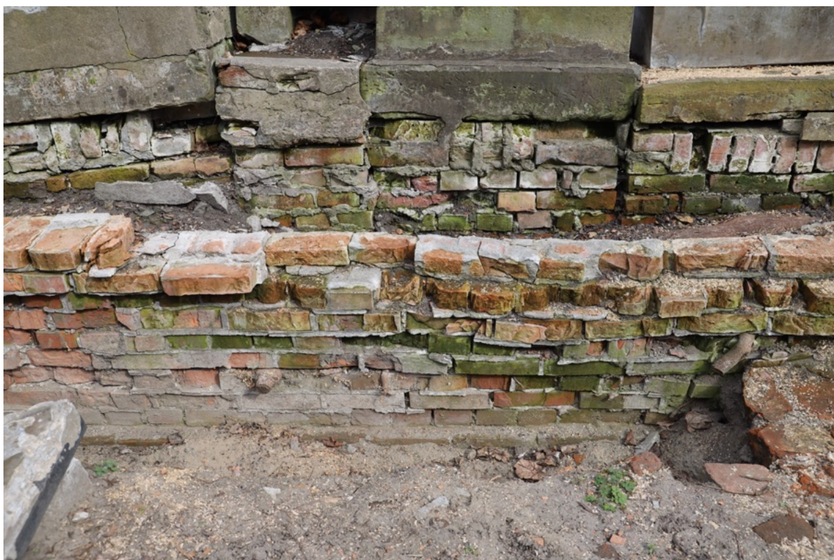
Foto. 179-180. Kwatera 31. Detal fragmentu ściany zachodniej z widocznym stopniem zniszczenia cegieł.
