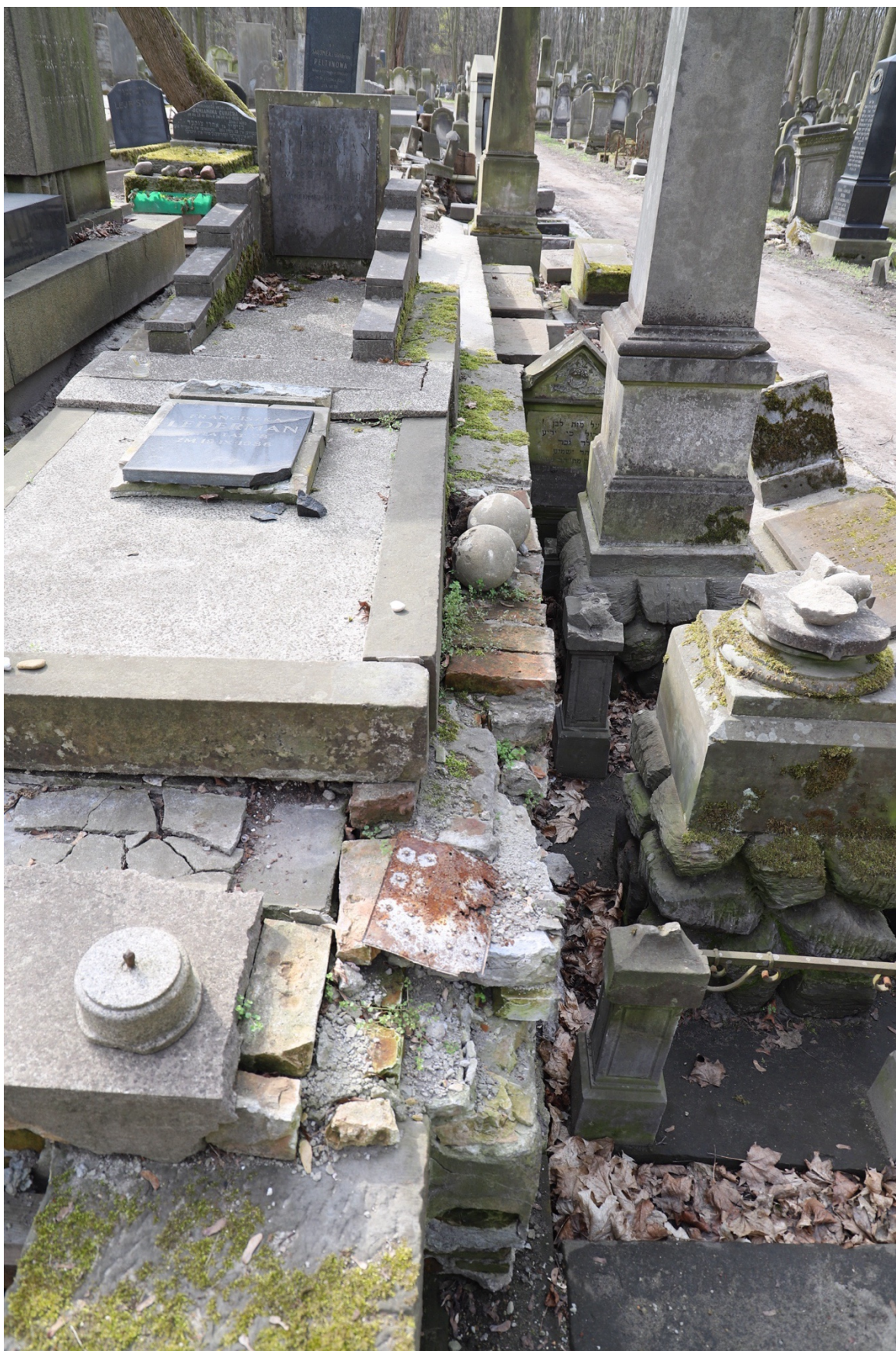
Foto. 185. Kwatera 31. Widok ogólny zwierczenia muru ściany północnej.
