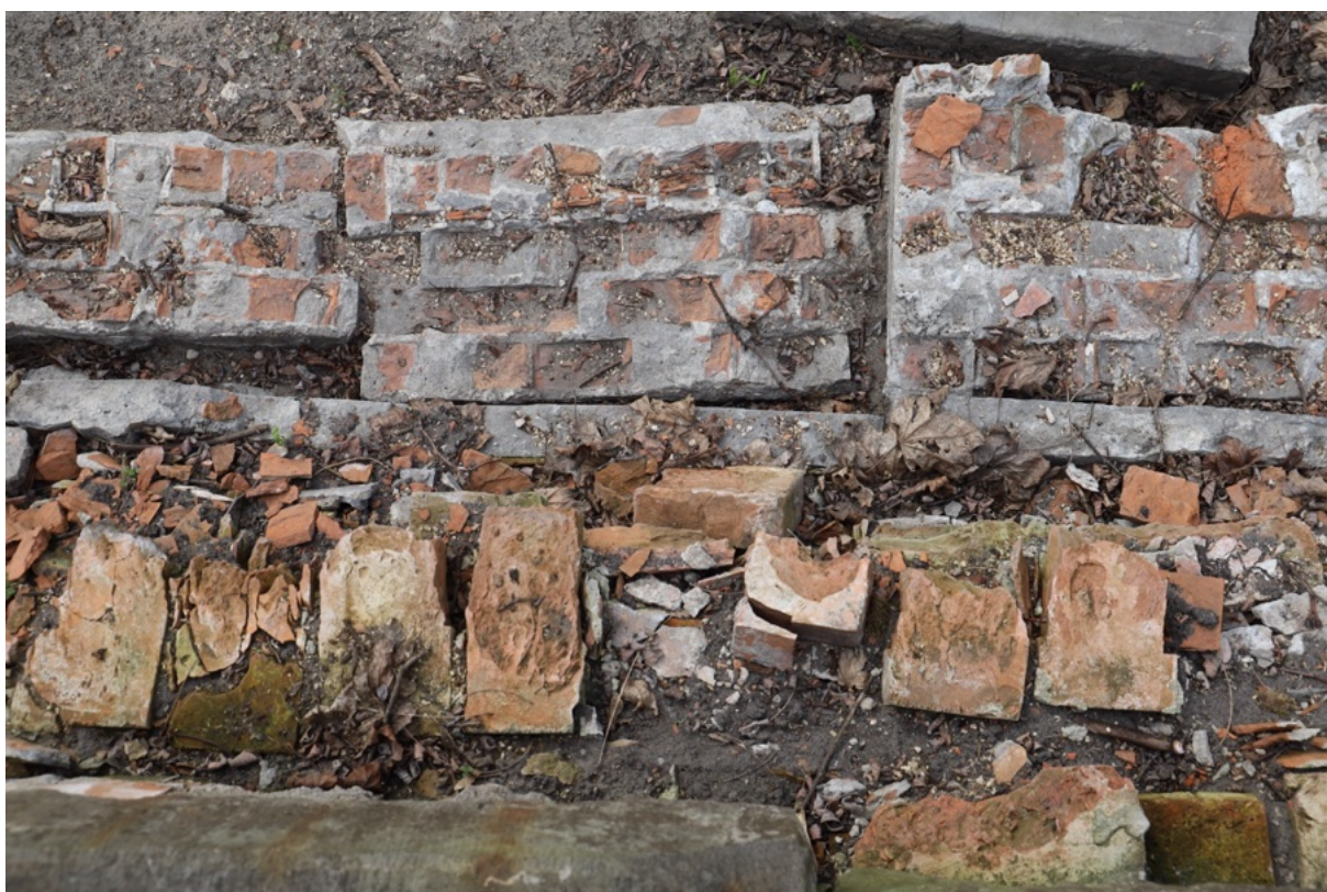
Foto. 159-160. Kwatera 31. Widok ogólny południowo-zachodniego narożnika oraz odspojonej cementowej wyprawy tynkarskiej.
