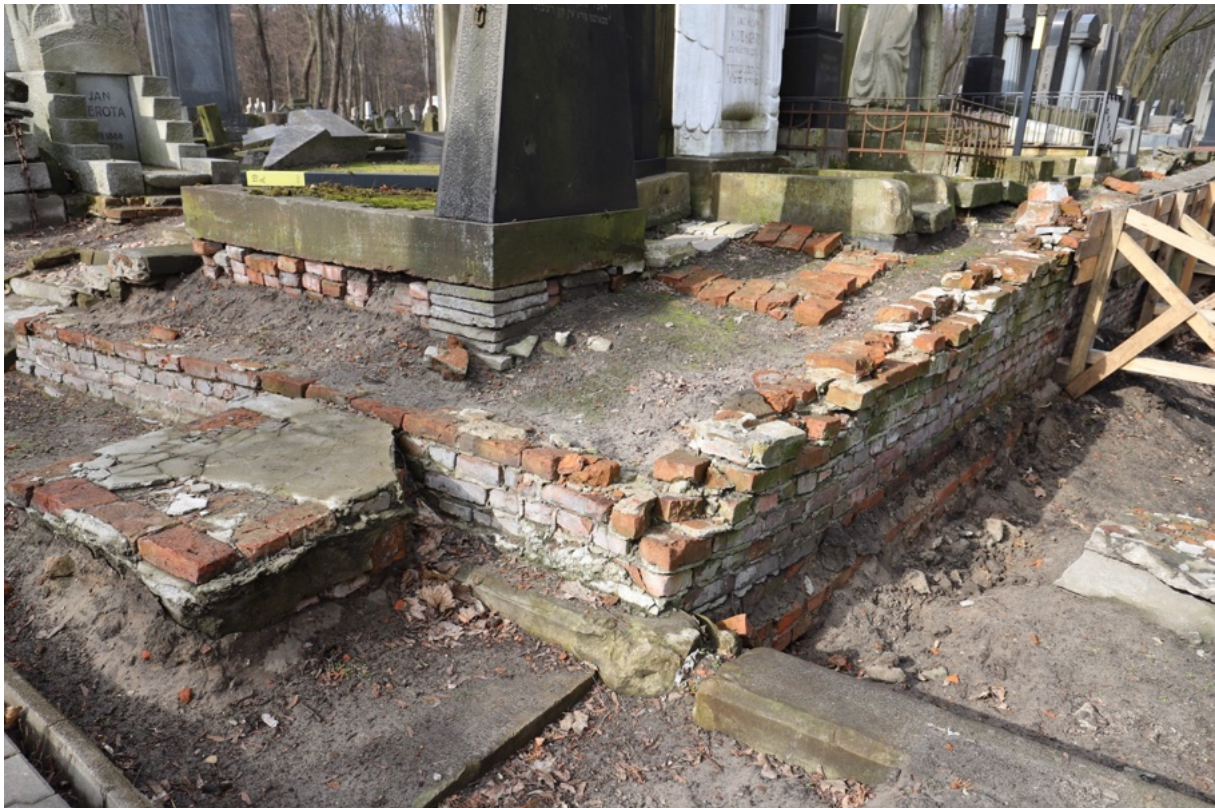
Foto. 3. Kwatera 19. Widok ogólny południowo-wschodniego narożnika z silnie zdestruowaną koroną muru .
