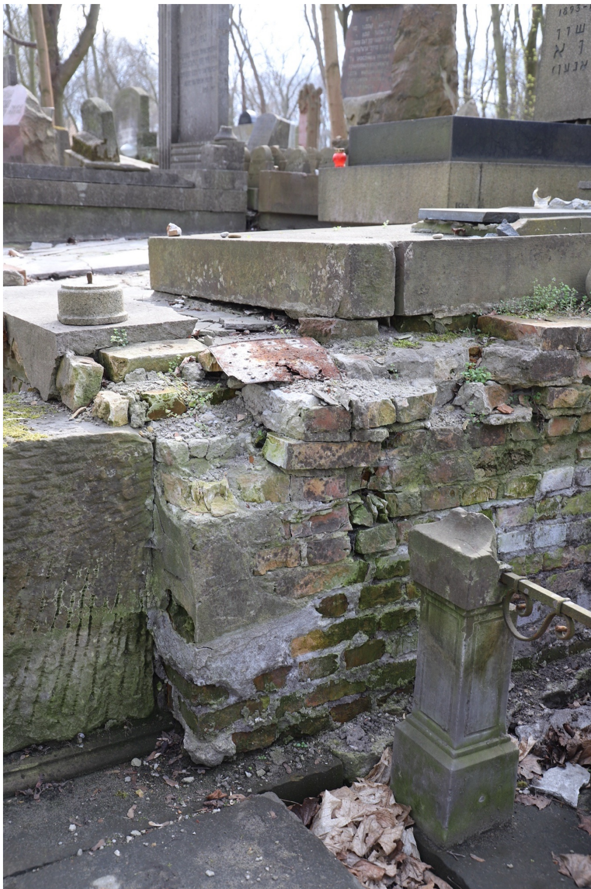
Foto. 184. Kwatera 31. Narożnik północno wschodni nabudowany na płycie podstawy nagrobkai z widocznym rozwarstwieniem wiązania.
