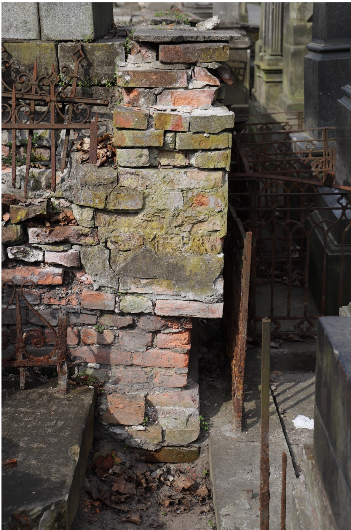
Foto. 45. Kwatera 24. Nawarstwienia i budowa stratygraficzna północno-wschodniego narożnika muru. Widoczna niejednorodna, rozwarstwiająca się struktura i rozspojone spoinowania oraz destrukcja wyższych partii.
