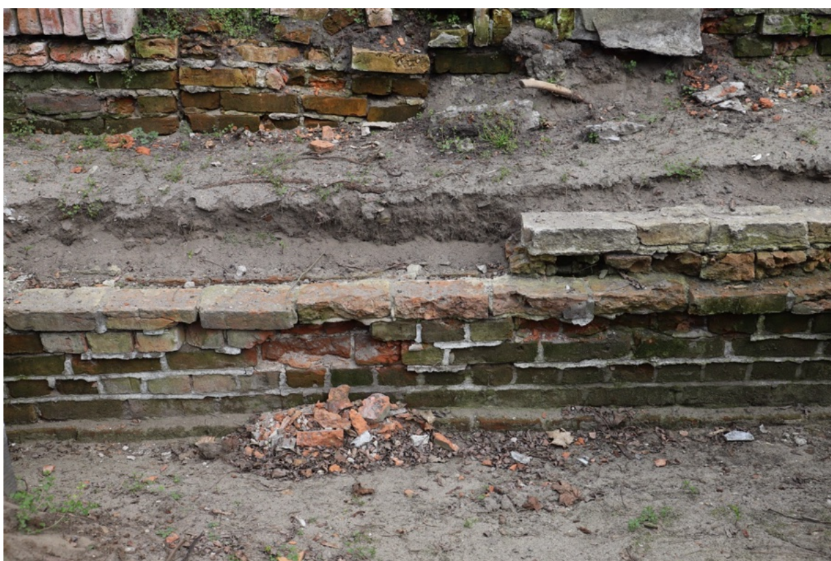
Foto. 7. Kwatera 24. Widok odcinków muru zachodniego. Widoczne silne zdestruowanie cegieł korony muru.
