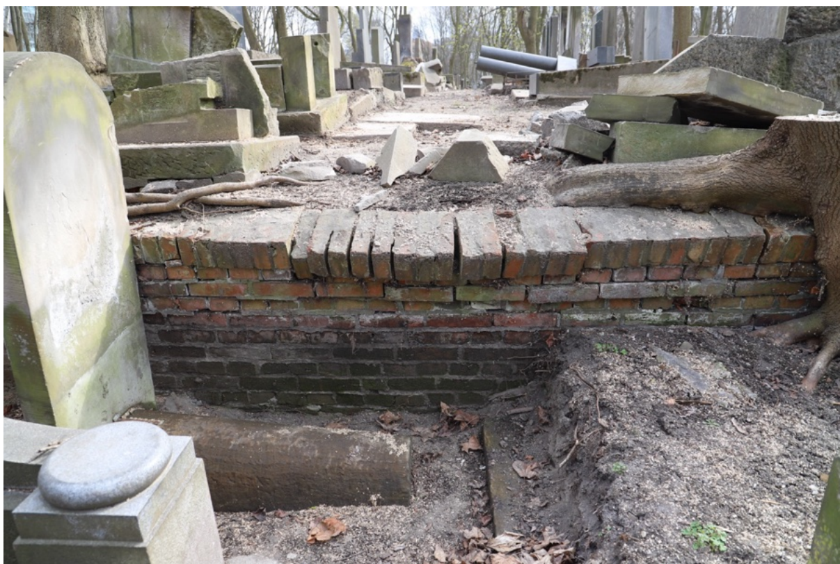
Foto. 197-198. Kwatera 31. Stan zachowania fragmentów muru ściany północnej.
