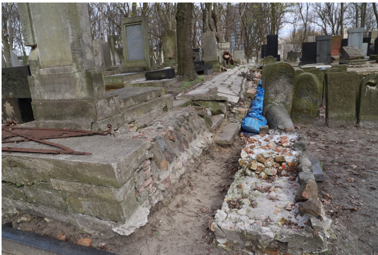
Foto. 110-173. Kwatera 31. Widok ogólny fragmentu ściany południowej z odspojoną masywną obudową nagrobka.
