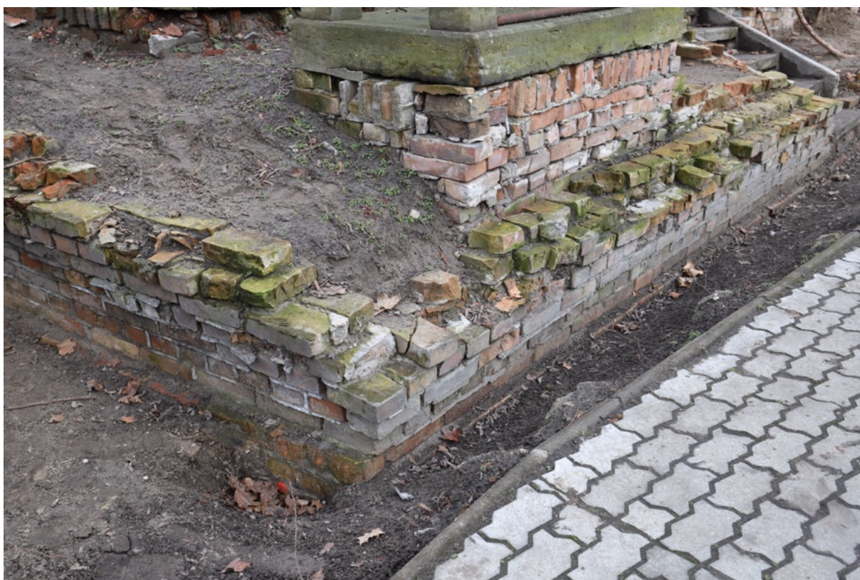
Foto. 71-72. Kwatera 24. Widok ogólny rozwarstwiających się murów odcinków strony południowej
