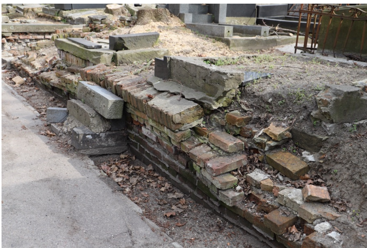
Foto. 83-84. Kwarta 24. Widok ogólny mocno przechylonych i powalonych odcinków strony północnej.
