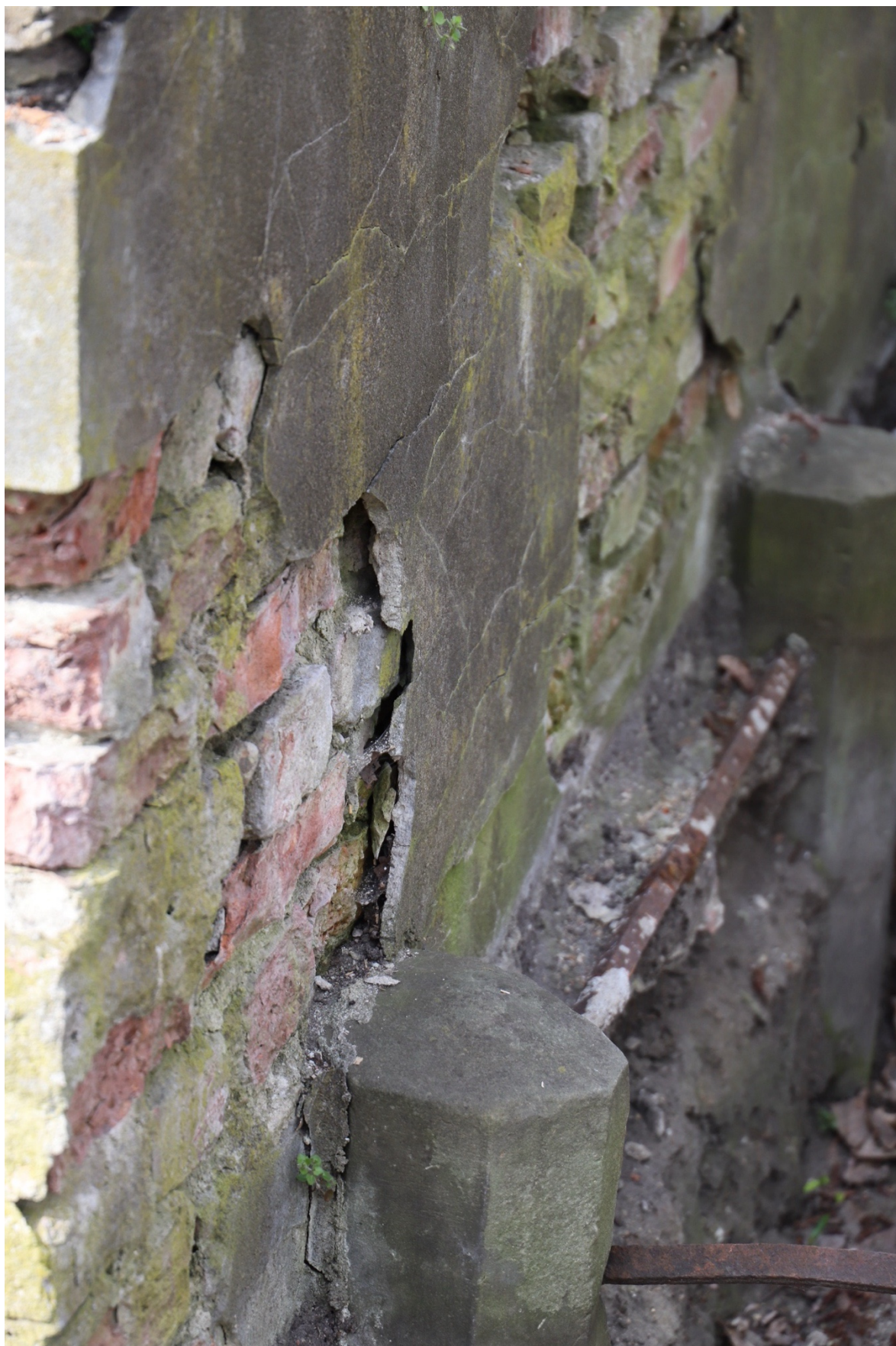
Foto. 144. Kwatera 31. Front muru wschodniego. Widoczne obudowywanie słupka ogrodzeniowego oraz rozwarstwienia tynków cementowych.
