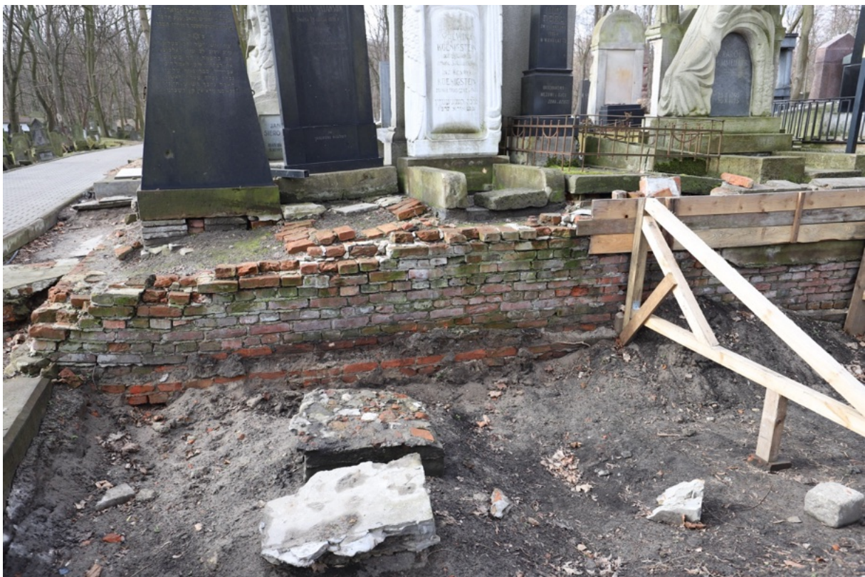
Foto. 4. Kwatera 19. Widok ogólny południowo-wschodniego narożnika z cegłą porażoną korozją mechaniczną i nawarstwieniami biologicznymi, wykwitami soli oraz brak fundamentu
