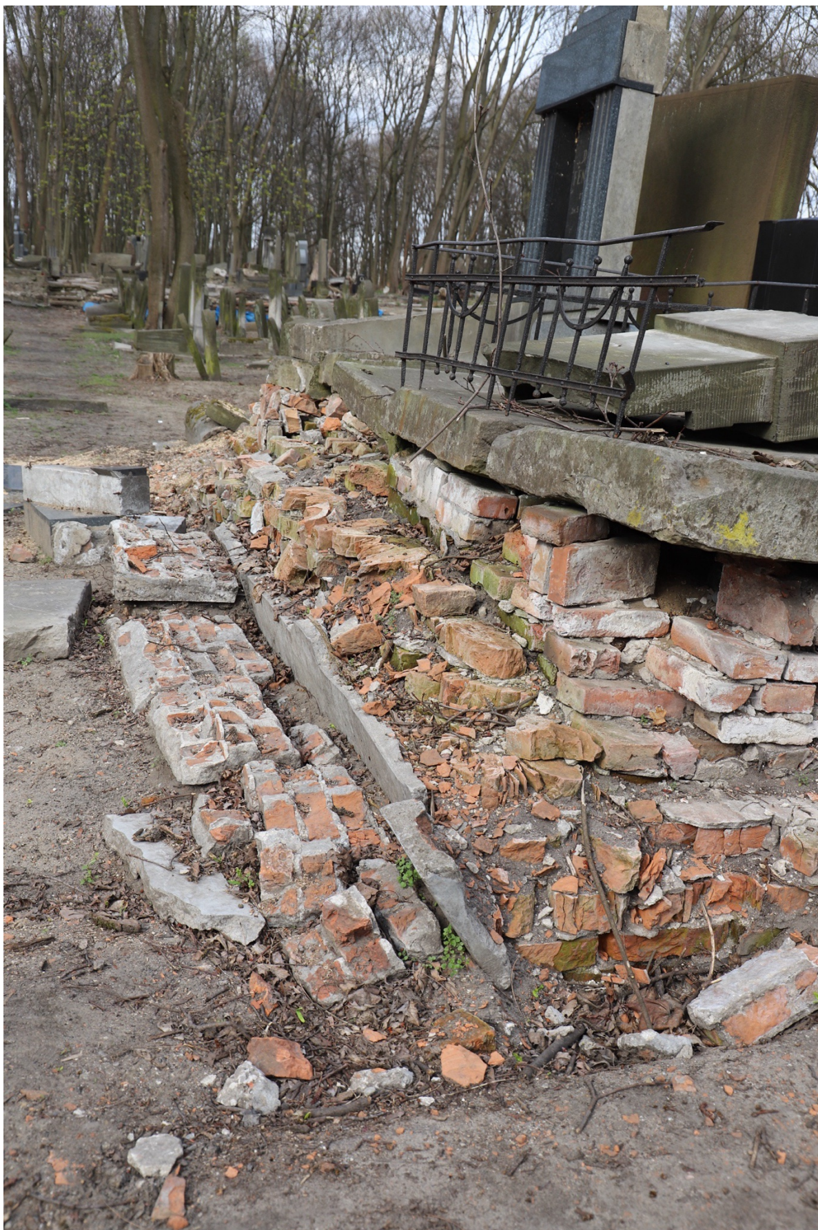
Foto. 163. Kwatera 31. Stan zachowania południowo-zachodniego narożnika. Widoczne katastrofalnie zdestruowane cegły tworzące mur oporowy.
