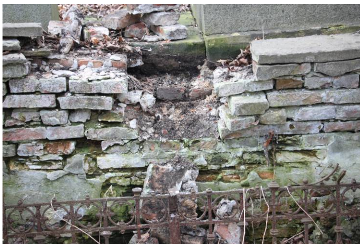
Fotografia nr. 14 Zbliżenie na reprezentatywną formę uszkodzeń murków ceglanych wokół kwater 19,24 i 31.
