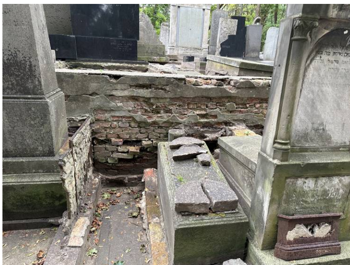
Fotografia nr. 10 Zdjęcie przedstawia uszkodzenia muru wynikające z działania czynników opisanych w niniejszej ekspertyzie.
