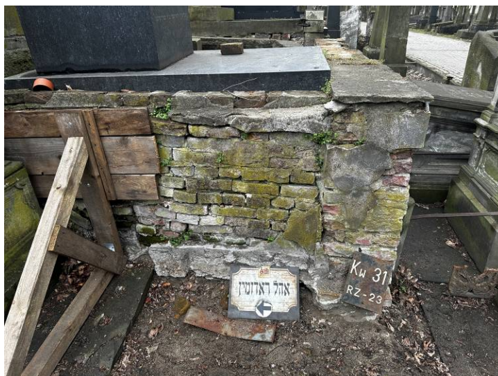
Fotografia nr. 7 Zdjęcie przedstawia uszkodzenie mechaniczno-konstrukcyjne ceglanych murków wokół kwater grzebalnych.
