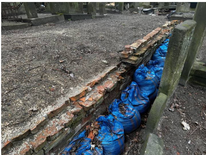
Fotografia nr. 8 Widoczne tymczasowe zabezpieczenie wychylonego murku ceglanoego poprzez stabilizację wykonaną workami z ziemią.
