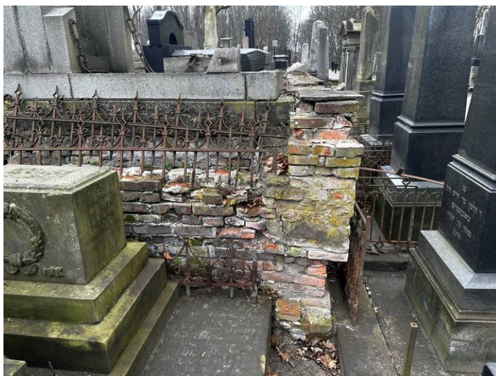
Fotografia nr.1 Zdjęcie przedstawia typową formę uszkodzeń wadliwego ustroju nośnego ceglanych murków.
