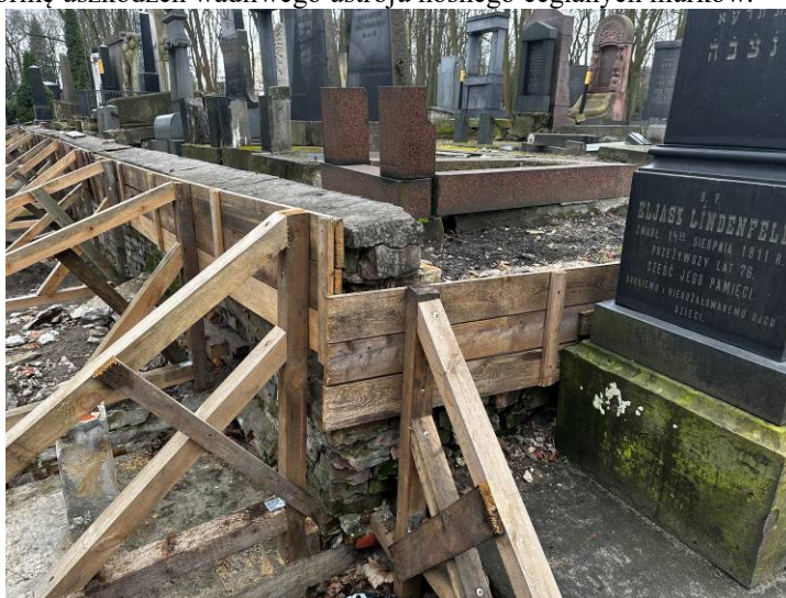
Fotografia nr.2 Zdjęcie przedstawia tymczasowe zabezpieczenia w postaci przypór drewnianych dla uszkodzonych ceglanych murków wokół kwater grzebalnych.
