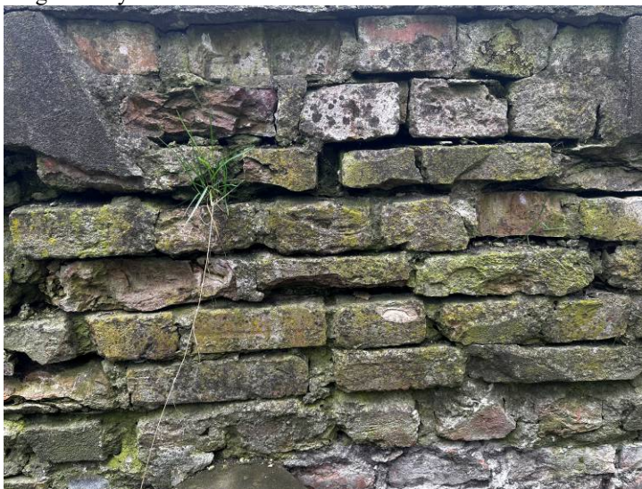
Fotografia nr.3 Widok uszkodzeń i wad techniczno-budowlanych związanych z wypłukaniem zapraw murarskich.
