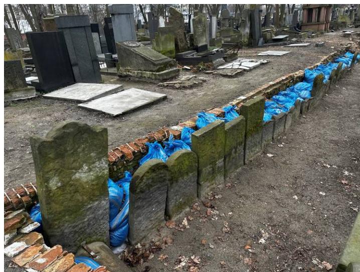
Fotografia nr. 9 Widoczne zabezpieczenie wychylonego murku ceglanoego poprzez stabilizację workami z ziemią
