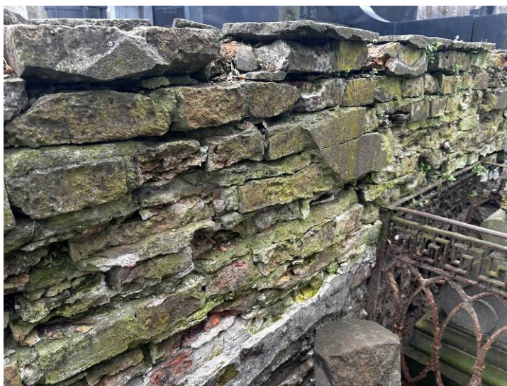
Fotografia nr. 4 Widok uszkodzeń techniczno-budowlanych związanych z wypłukaniem zapraw murarskich oraz ubytkami struktury ceglanej konstrukcji murowej.
