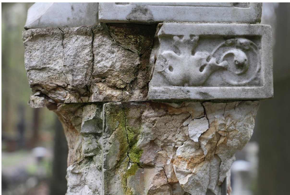
Foto 16,17,18. Nagrobek Jakóba Eigera, zaawansowany rozpad jednej ze zrekonstruowanych podpór. Bardzo szybko postępujący rozpad połowy ze wszystkich podpór może doprowadzić do powalenia konstrukcji.
