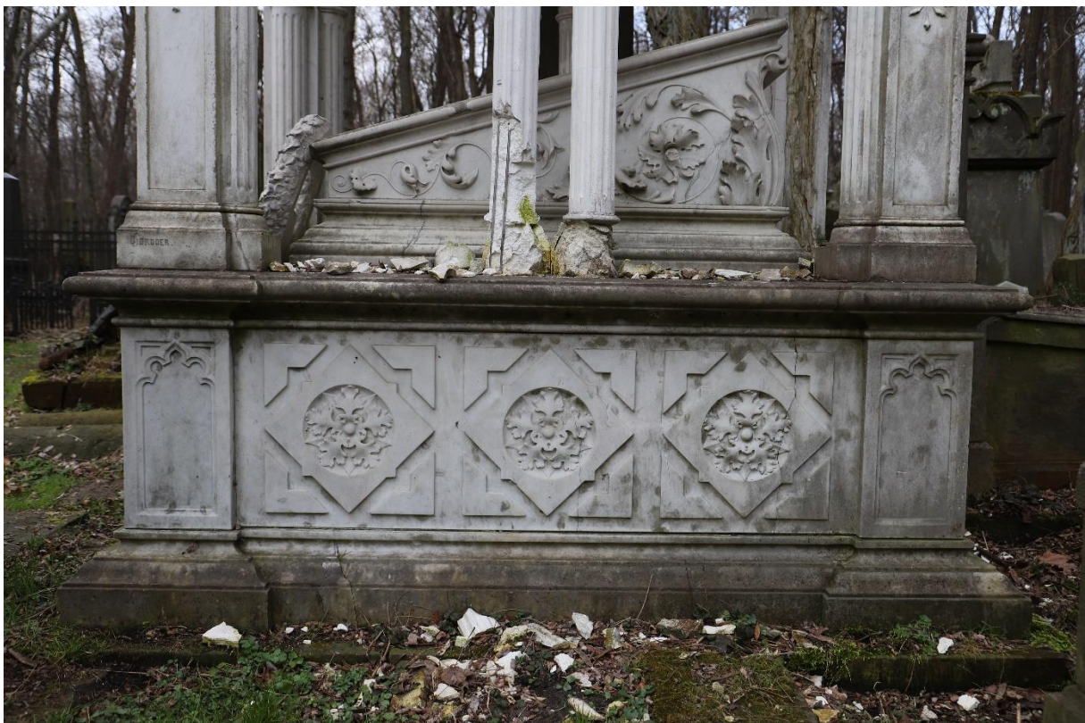
Foto 7. Nagrobek Jakóba Eigera, cokół z widocznymi intensywnymi nawarstwieniami biologiczno-chemicznymi oraz pionowe pęknięcia występujące na każdym marmurowym elemencie. Piaskowcowa płyta podstawy prawie w całości przykryta warstwą ziemi i humusu. Fot Damian Pisarski, kwiecień 2023 r.
