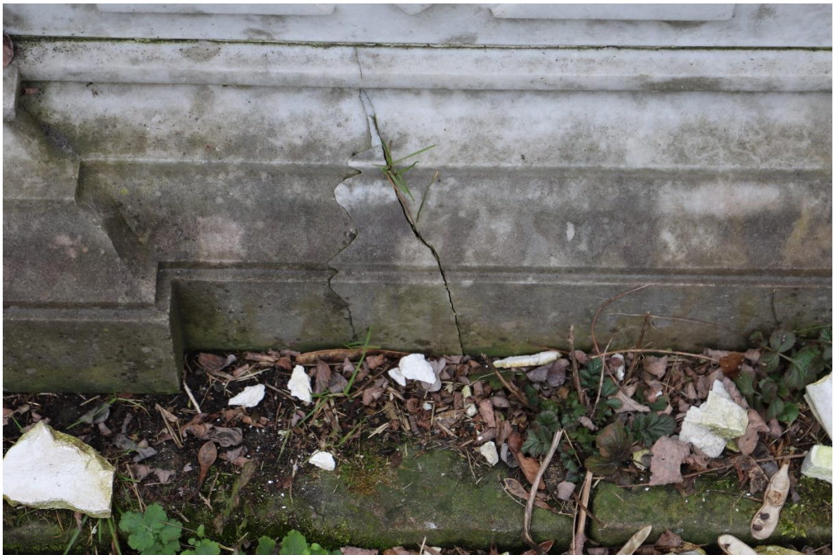
Foto 8, 9. Nagrobek Jakóba Eigera, pęknięcia konstrukcyjne w cokole . Fot Damian Pisarski, kwiecień 2023 r.
