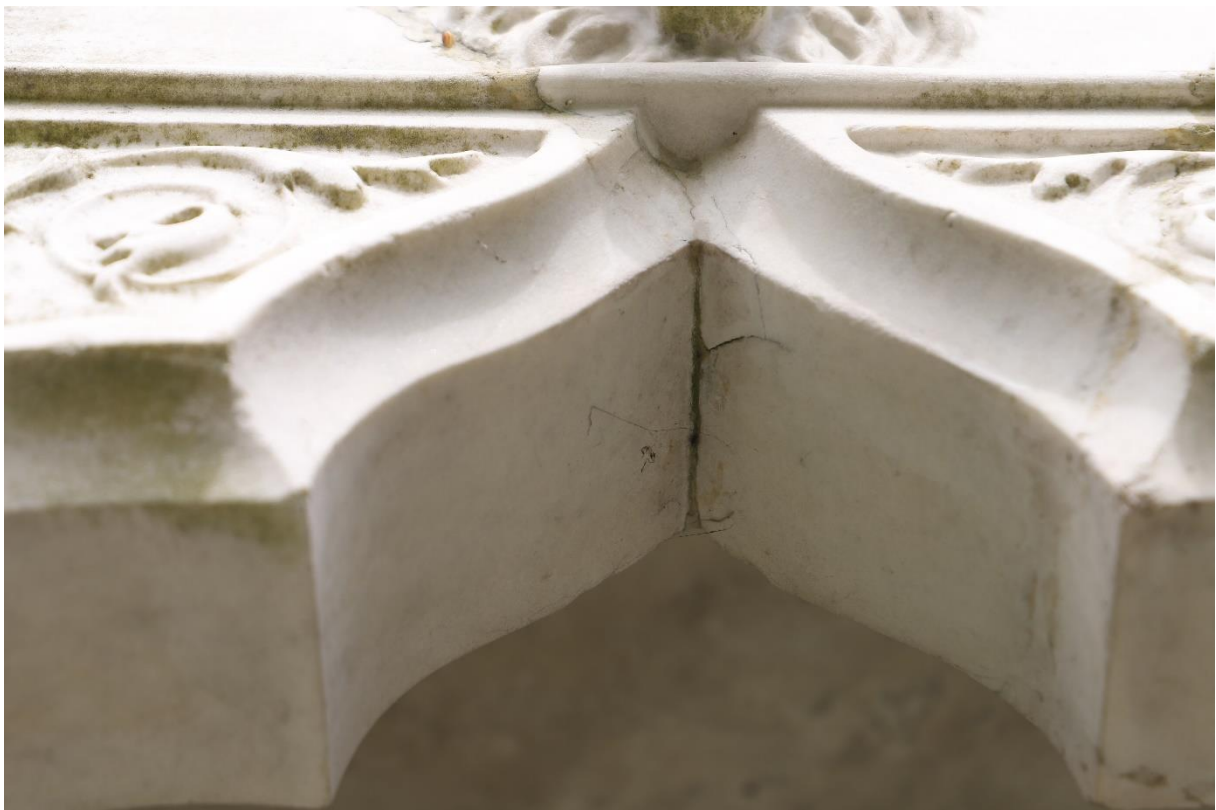
Foto 10, 11, Nagrobek Jakóba Eigera, pęknięcia konstrukcyjne w katafalki i zwieńczeniu . Fot Damian Pisarski, kwiecień 2023
