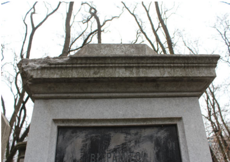
Fot. Ubytki formy.
