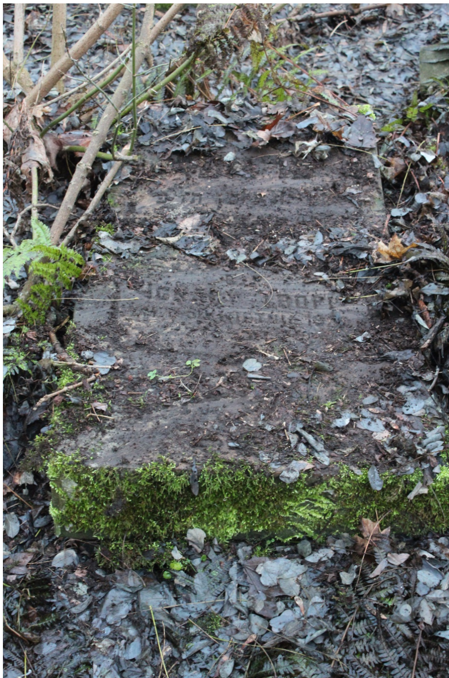
Foto. 1 Nagrobek Ignacego Troppa [sektor 22, rząd 23, nr 5]. Widok ogólny pokrytego grubą warstwą mchów, resztek ziemi i innych biologiczno-chemicznych nawarstwień. Widoczne pęknięcie płyty i przemieszczenie jej części. Fot. D. Pisarski, 2017 r.
