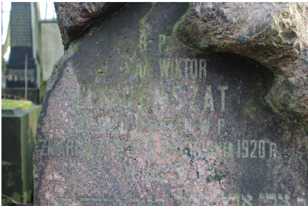
Foto. 3. Nagrobek Hermana Wiktora Lindenszat [sektor 64a, rząd 1, nr 4]. Detal. Zwietrzała powierzchnia pola inskrypcji. Widoczne nawarstwienia biologiczno-chemiczne. Fot. Damian Pisarski. 2018r.
