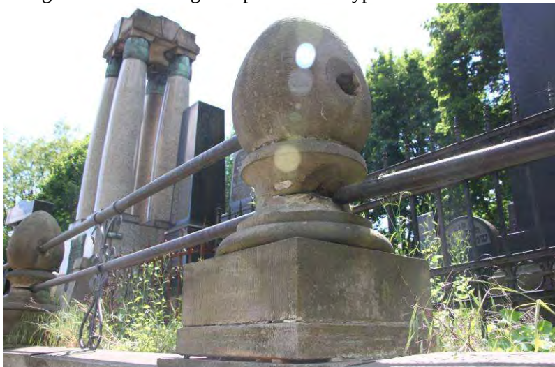
Fotografia nr. 29 Fotografia przedstawia typowe uszkodzenie kamiennych detali. Widoczne uszkodzenia na styku kamień-stal oraz powstanie szczelin wynikających z deformacji geometrycznej.
