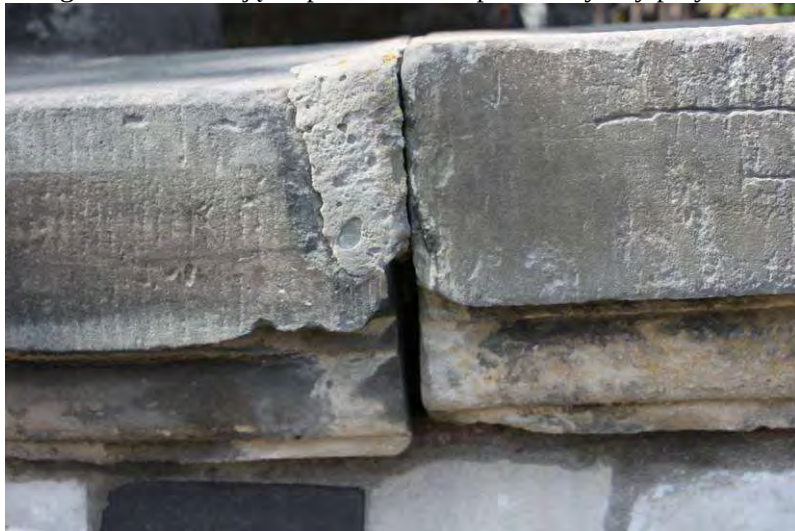
Fotografia nr. 17 Zdjęcie przedstawia kolejne widoczne miejsce uszkodzeń na linii łączenia nakryw kamiennych.
