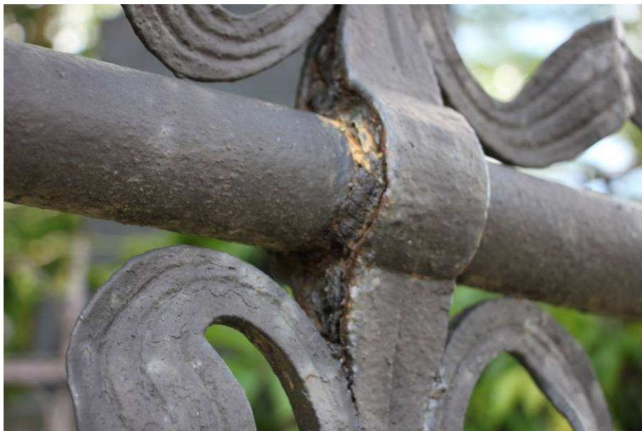
Fotografia nr. 19 Zdjęcie przedstawia zbliżenie na uszkodzenia wraz z widocznym procesem korozyjnym elementu.
