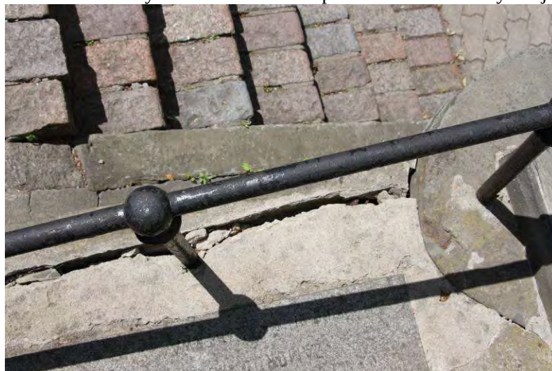
Fotografia nr. 30 Fotografia przedstawia typowe uszkodzenie muru oporowego .
