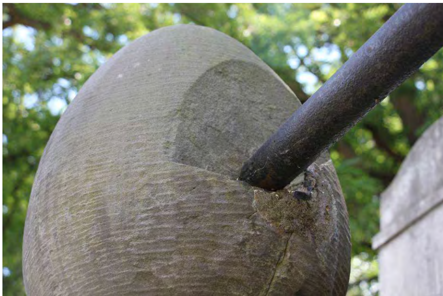
Fotografia nr. 26 Fotografia przedstawia typowe ubytki w elementach kamiennych wynikające z wpływu zginanych elementów stalowych.
