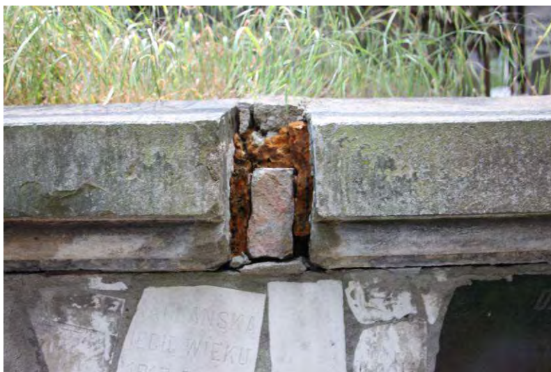
Fotografia nr. 33 Fotografia przedstawia nieprawidłowe rozwiązanie techniczne z wykorzystaniem pianki polipropylenowej niskorozprężnej oraz uzupełnienia ubytków poprzez ułożenie cegły ceramicznej.
