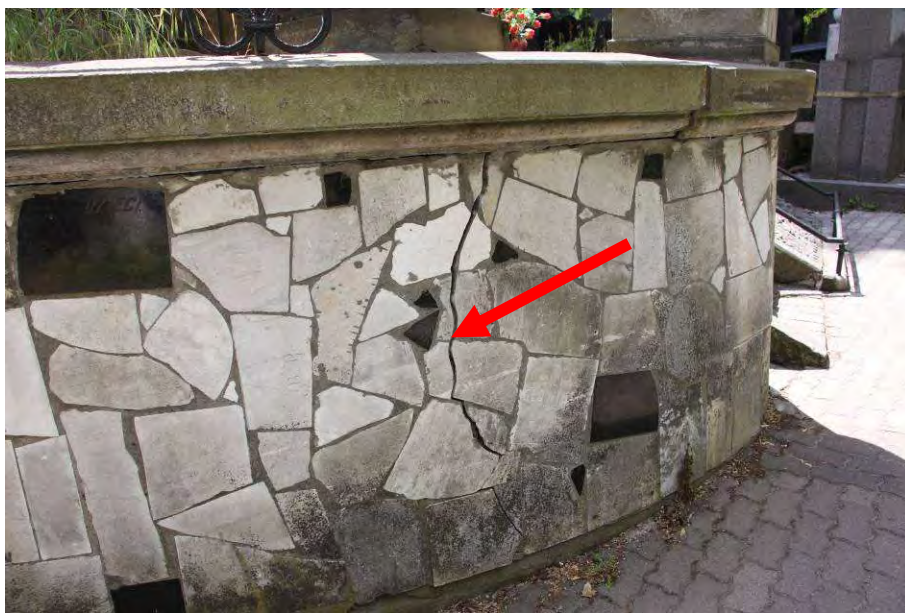
Fotografia nr. 32 Fotografia przedstawia uszkodzenie konstrukcyjne na zakończeniu muru oporowego.
