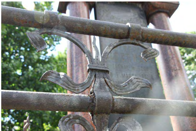
Fotografia nr. 28 Fotografia przedstawia typowe uszkodzenie elementu stalowego.
