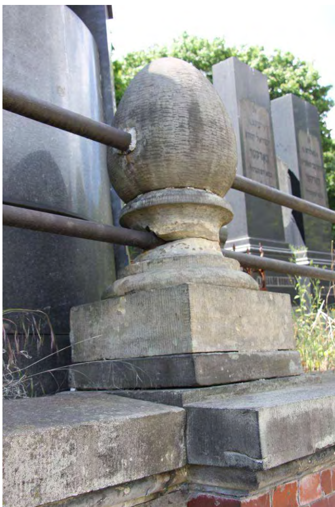
Fotografia nr. 27 Fotografia przedstawia deformację geometryczną elementów kamiennych. Wychylenie od pionu elementu spowodowane jest wahadłową pracą przęseł muru oporowego.
