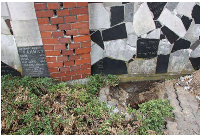
Fotografia nr. 4 Zdjęcie przedstawia uszkodzenia filarka ceglanego.
