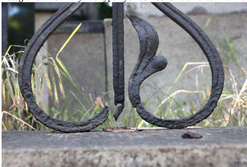
Fotografia nr. 35. Przykład znacznych uszkodzeń detali stalowych muru oporowego.
