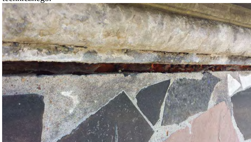
Fotografia nr. 38 Zdjęcie dokumentuje nieprawidłowe rozwiązanie łączy (styku) kamienia z elementami ceramicznymi.
