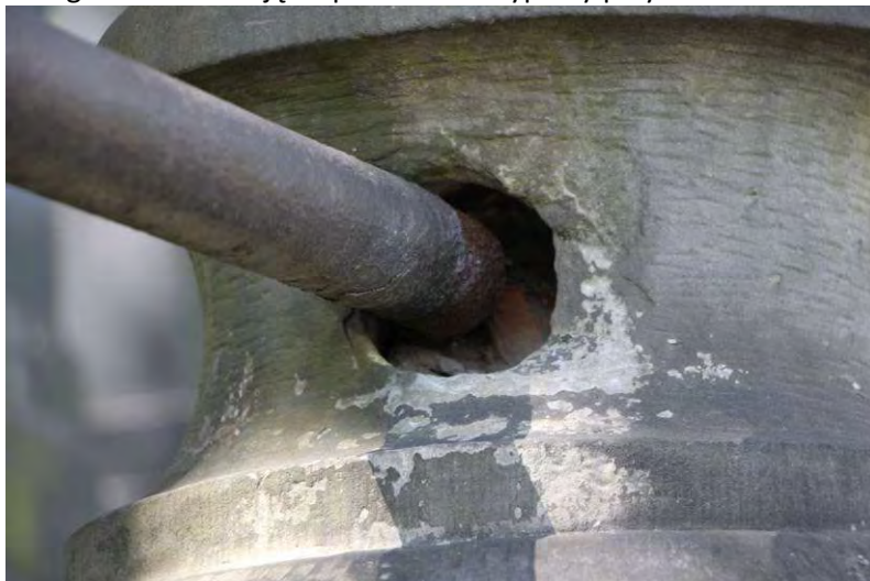
Fotografia nr. 22 Fotografia przedstawia formę zniszczenia wynikająca z wahadłowej pracy poszczególnych przęseł muru oporowego.
