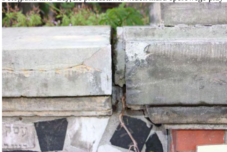
Fotografia nr.2 Zdjęcie przedstawia typowe uszkodzenie pomiędzy kamiennymi elementami nakryw.
