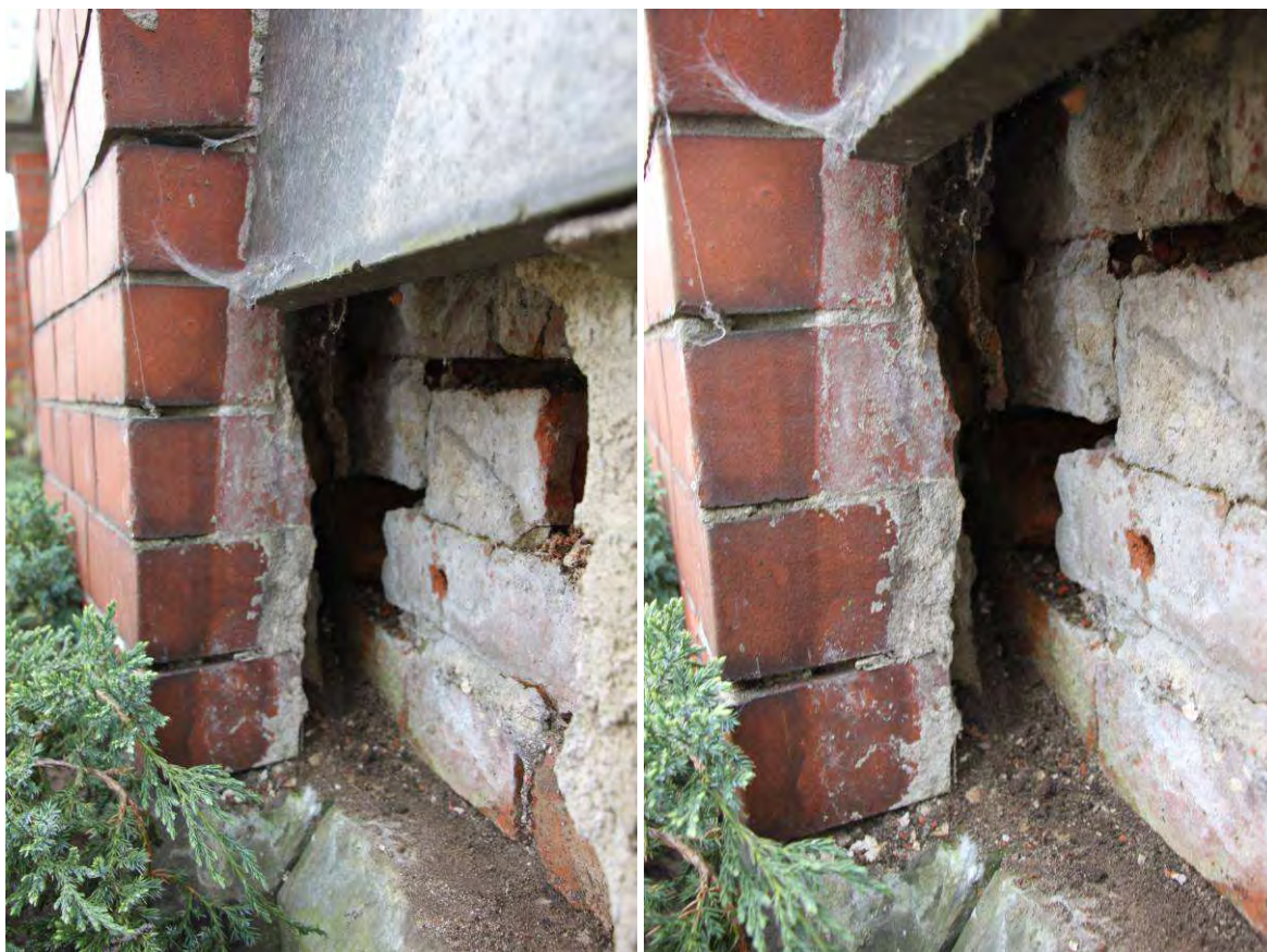
Fotografia nr. 7 Zdjęcie przedstawia zbliżenie na wykonaną odkrywkę. Widoczne odspojenie cegły filarka od właściwego muru oporowego.
