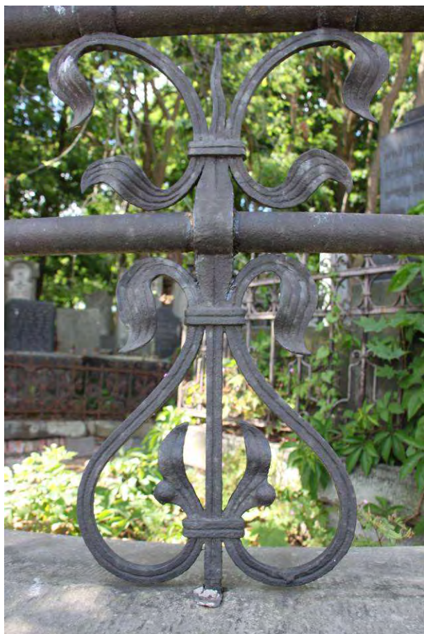
Fotografia nr. 18 Zdjęcie przedstawia uszkodzenia detali architektonicznych wykonanych ze stali i żeliwa.
