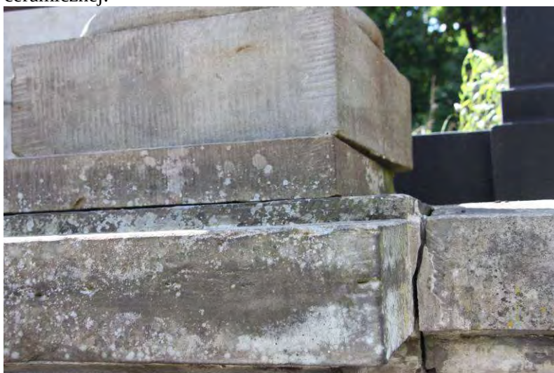
Fotografia nr. 34 Przykład typowych uszkodzeń elementów kamiennych .
