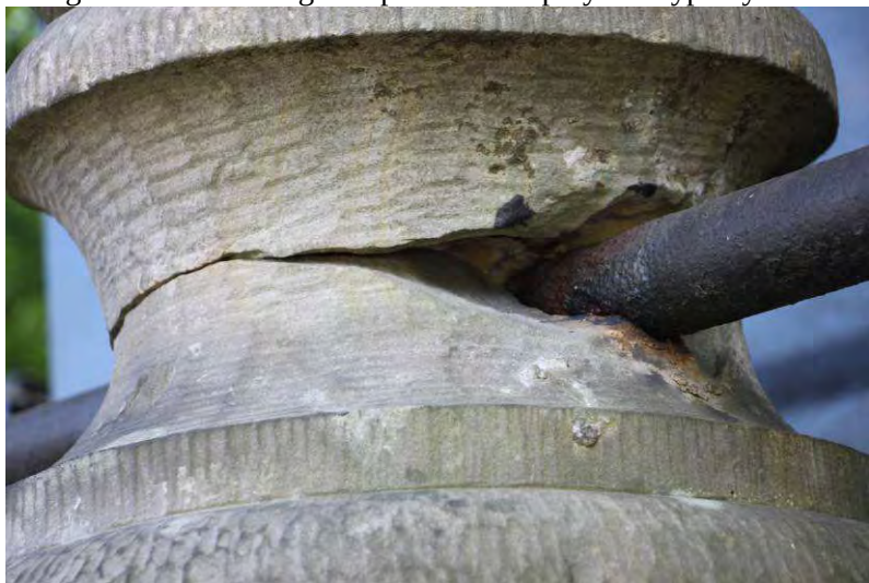
Fotografia nr. 25 Fotografia przedstawia przykład typowych uszkodzeń detalu kamiennego na styku z elementami rurowymi stalowymi.
