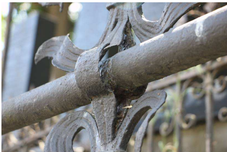
Fotografia nr. 23 Fotografia przedstawia przykład typowych uszkodzeń detalu stalowego.
