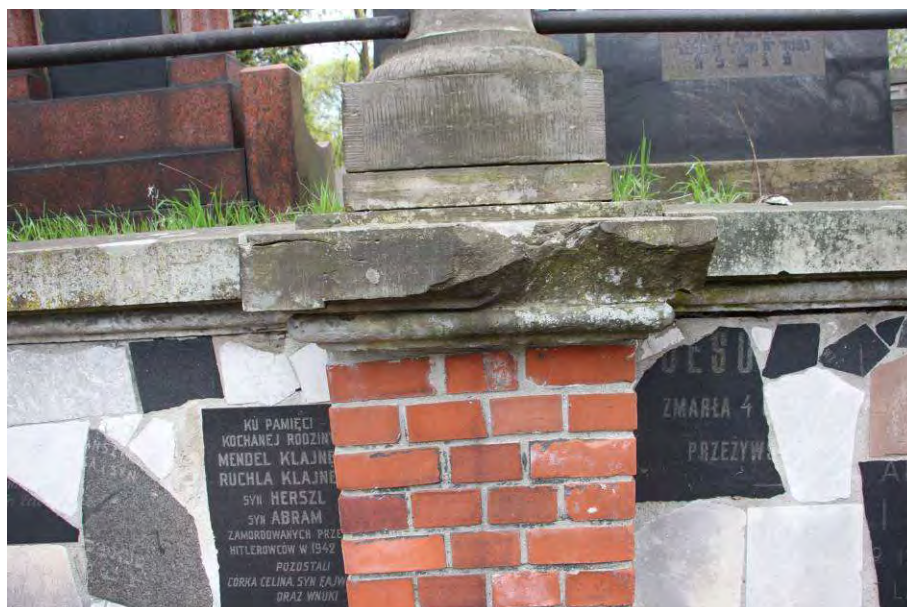
Fotografia nr. 8 Fotografia przedstawiająca uszkodzenia nakrywy kamiennej.
