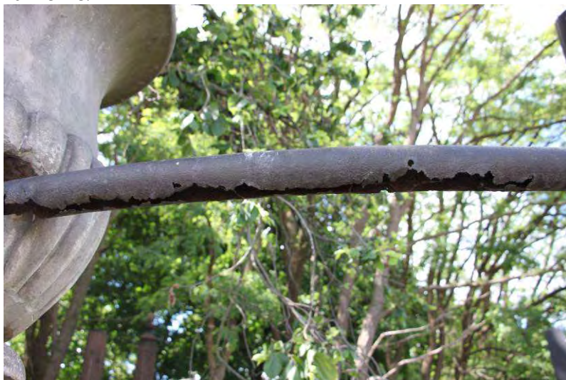
Fotografia nr. 16 Zdjęcie przedstawia reprezentatywny przykład uszkodzenia elementów stalowych.
