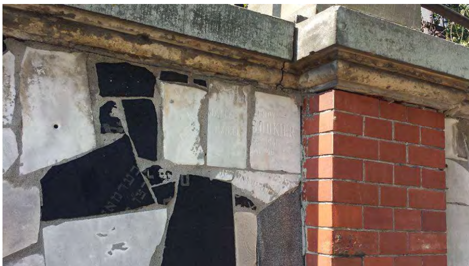
Fotografia nr. 39 Przedstawia widoczne uszkodzenia i zarysowania na styku łączenia elementów ze sobą.
