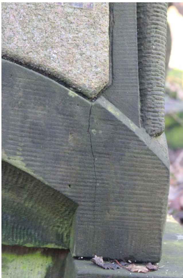
Foto. 3. Nagrobek Akiwy Gurewicza [sektor 51, rząd 33, nr 21]. Detal. Widoczne biologiczno-chemiczne nawarstwienia i spękania. Fot. Damian Pisarski. 2017r.
