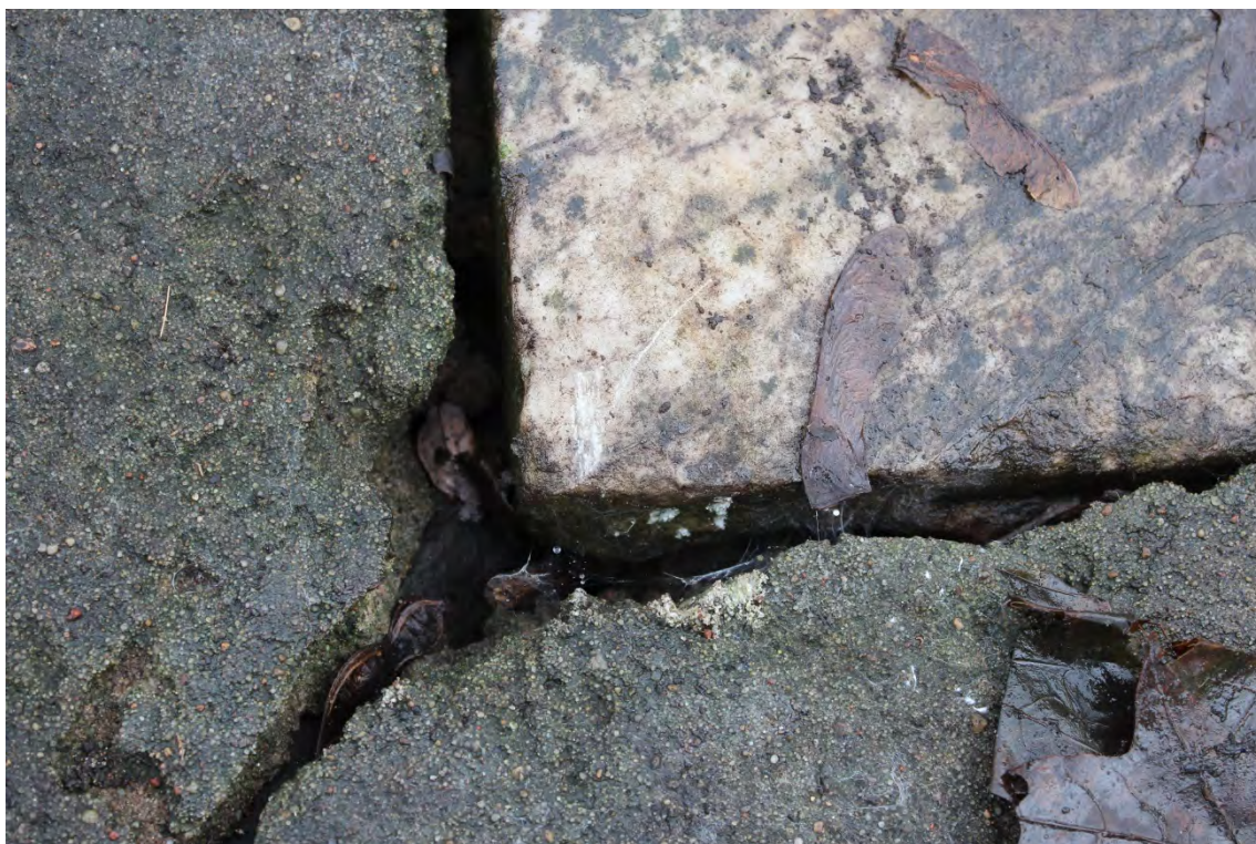
Foto. 3. Nagrobek Adolfa Truskiera [sektor 10, rząd 3f, nr 18]. Detal. Odspojona płyta marmurowa ze szczątkowymi resztkami spoiny. Bardzo głębokie pęknięcia betonowej płyty. Fot. D. Pisarski. 2017 r.
