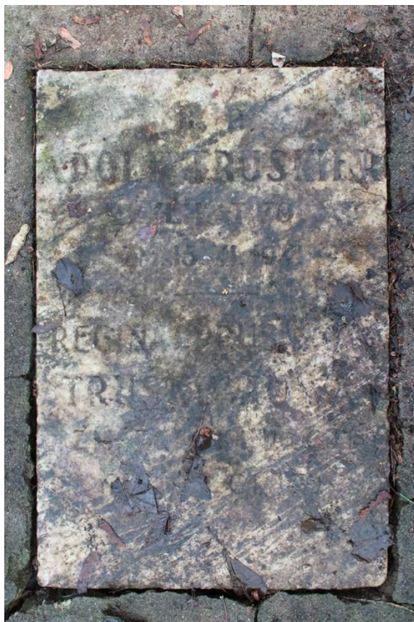
Foto. 2 Nagrobek Adolfa Truskiera [sektor 10, rząd 3f, nr 18]. Odspojona, pokryta nawarstwieniami, zwietrzała płyta marmurowa z miejscowo nieczytelną inskrypcją. Fot. D. Pisarski. 2017r.
