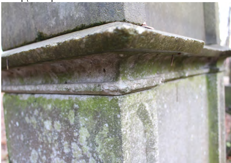
Fot. Ubytki formy, dezintegracja kamienia.
